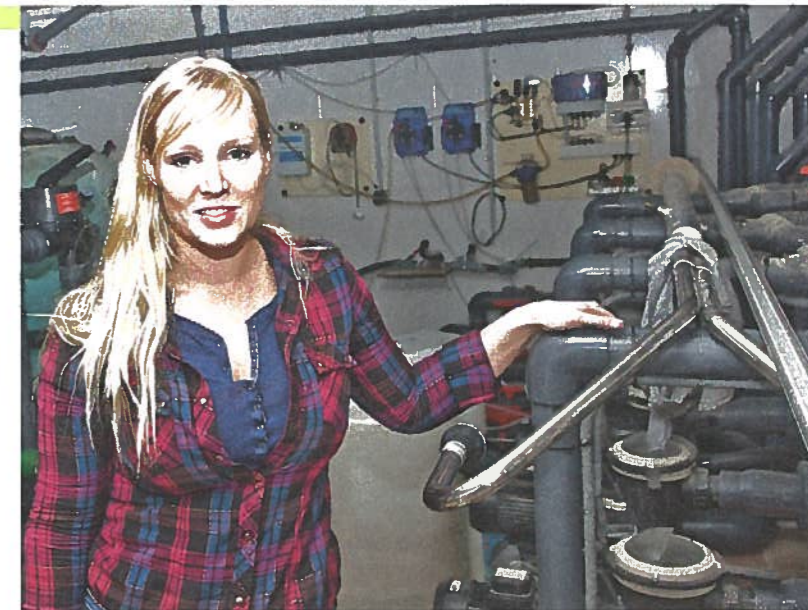
Stringingsystemer til svømmebasseng er det sjelden Marie Neerland møter i sitt daglige virke i Trondheim.
